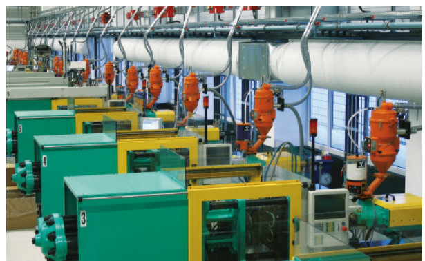
Zentrale Materialversorgungsanlage mit Direkteinfärbung - Beispielhaftes System für flexible Materialversorgung mit Industrie 4.0
