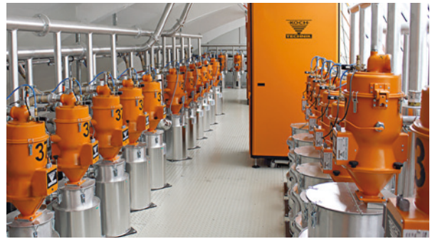
Die zentrale Granulattrockner-Anlage mit insgesamt drei Trockenlufttrockner vom Typ CKT versorgen bei der Procter & Gamble Manufacturing GmbH 38 Trocknungsbehälter mit einer Trockenluftmenge bis zu 1600\text{ m}^3/\text{h}
