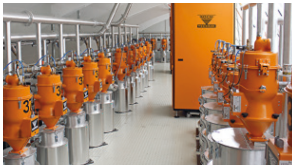
Centralny system osuszania granulatów z trzema osuszaczami powietrza typu CKT dostarcza w firmie Procter & Gamble Manufacturing GmbH powietrze suche do 38 pojemników do osuszania, z przepływem powietrza do 1600 m 3 /h.
